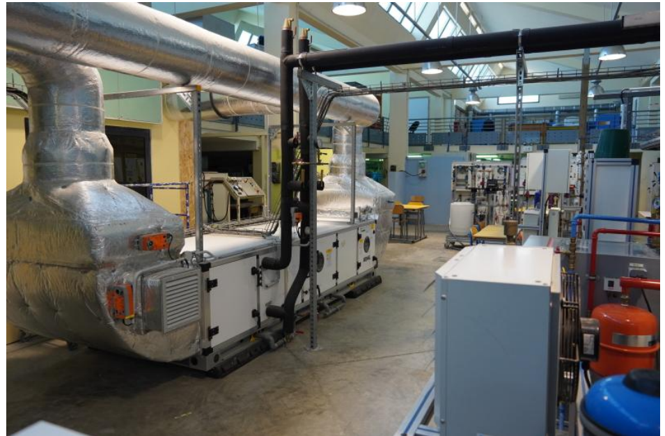
Centrale de Traitement d'Air avec pompe à chaleur
